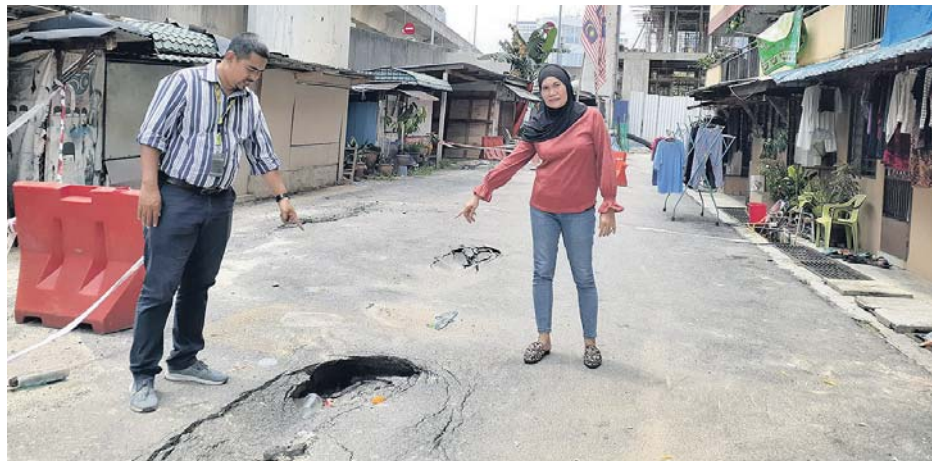
Penduduk menunjukkan keadaan jalan yang mendap di Flat PKNS Jalan Tun Razak semalam.
